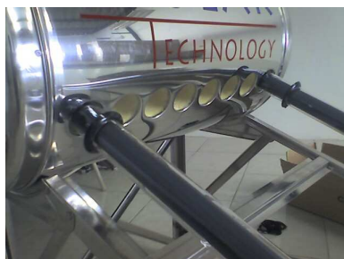
Figura 8 alineación del termotanque
